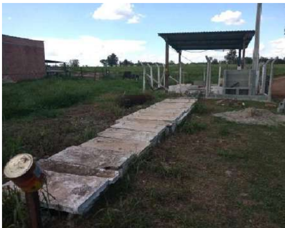
Figura 167 - EEEB Millenium Fonte: Amplar Engenharia
