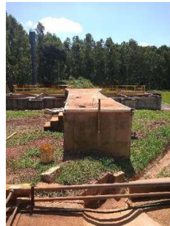
Figura 193 - Caixa de Gordura ETE Laranja Azeda Fonte: Amplar Engenharia
