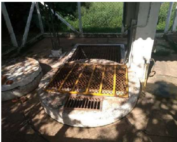
Figura 165 - EEEB Verona Fonte: Amplar Engenharia
