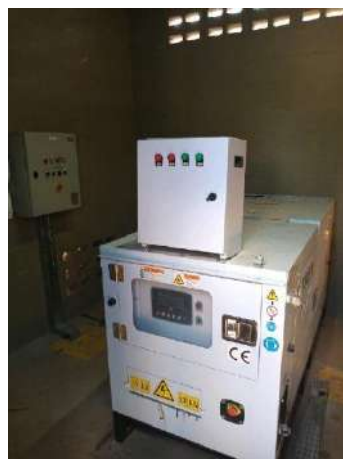
Figura 174 - EEEB Amente Fonte: Amplar Engenharia
