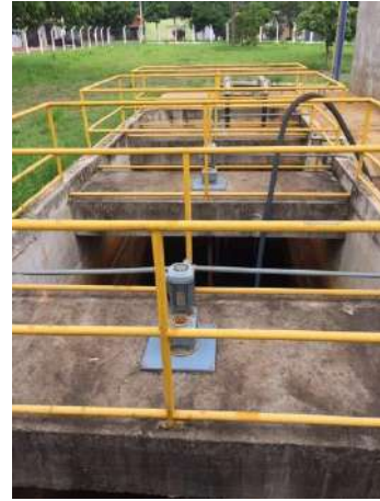
Figura 109 - Sistema de Tratamento de Lodo Fonte: Amplar Engenharia
