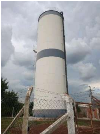
Figura 132 - Reservatório Jd. Treviso Fonte: Amplar Engenharia
