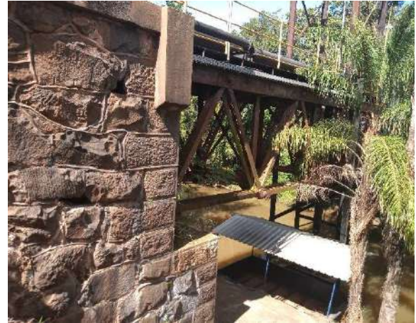
Figura 29 - Captação do Ribeirão do Roque Fonte: Amplar Engenharia
