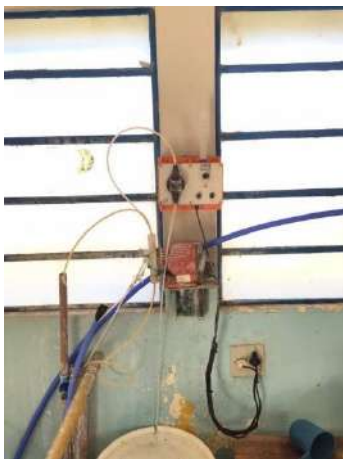
Figura 58 - Dosadora de Flúor Fonte: Amplar Engenharia
