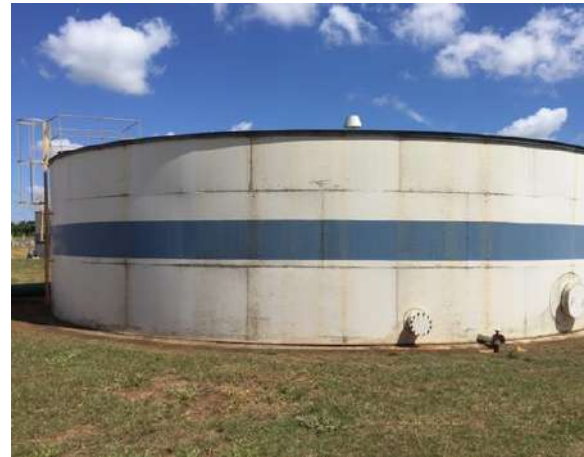
Figura 121 - R8 das ETAs II e III Fonte: Amplar Engenharia
