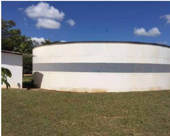
Figura 120 - R7 das ETAs II e III Fonte: Amplar Engenharia
