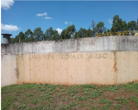
Figura 196 - Caixa repartidora de vazão Fonte: Amplar Engenharia
