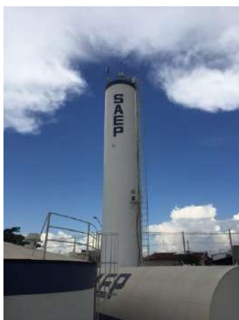
Figura 140 - Reservatório elevado ETA Sta. Fé Fonte: Amplar Engenharia
