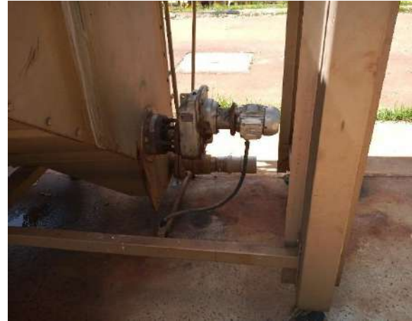
Figura 191 - Motor que necessita de manutenção Fonte: Amplar Engenharia
