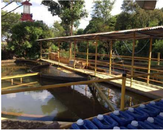
Figura 48 - Vista Geral ETA I Fonte: Amplar Engenharia
