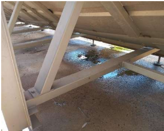
Figura 192 - Vazamento no Tanque da Estação de Pré-Tratamento Fonte: Amplar Engenharia
