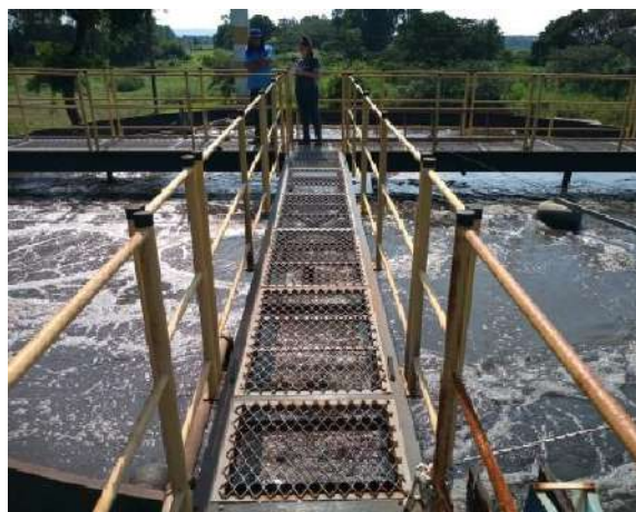
Figura 213 - Reatores aeróbios de lodos ativada da ETE Santa Fé Fonte: Amplar Engenharia
