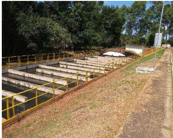
Figura 202 - Desinfecção ETE Laranja Azeda Fonte: Amplar Engenharia
