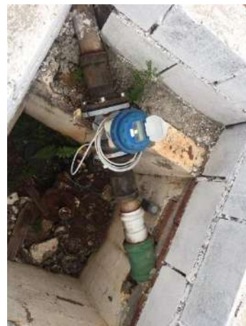
Figura 105 - Medidor de vazão de saída Fonte: Amplar Engenharia
