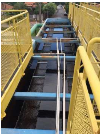
Figura 98 - Decantador 2 Fonte: Amplar Engenharia
