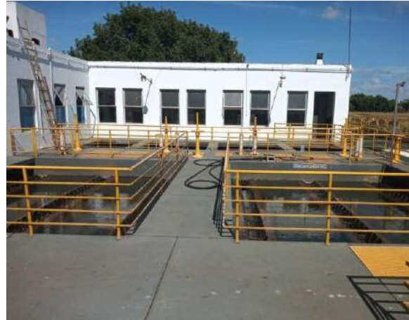
Figura 64 - Foto geral do Tratamento da ETA II Fonte: Amplar Engenharia
