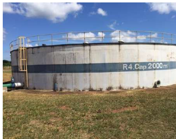
Figura 117 - R4 das ETAs II e III Fonte: Amplar Engenharia
