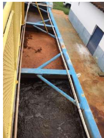
Figura 99 - Flocculador Fonte: Amplar Engenharia
