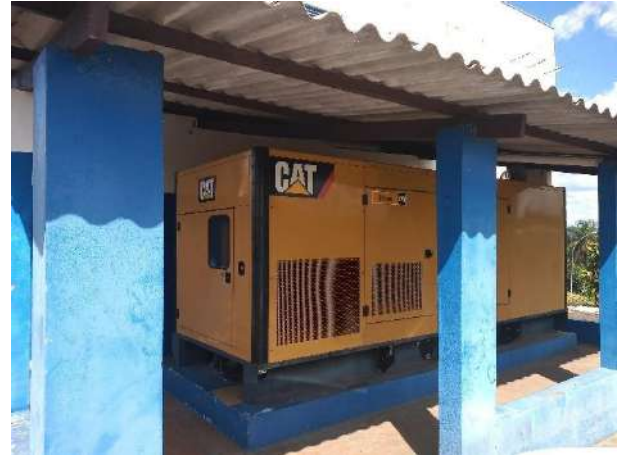
Figura 41 - Gerador de energia da Captação Fonte: Amplar Engenharia
