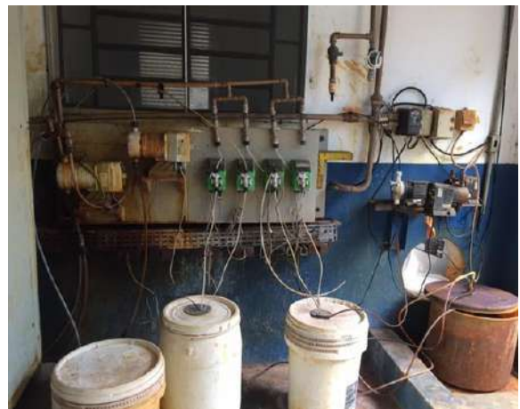
Figura 57 - Unidade de desinfecção Fonte: Amplar Engenharia
