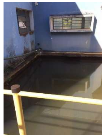
Figura 53 - Filtro 3 ETA I Fonte: Amplar Engenharia
