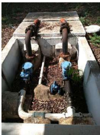
Figura 177 - EEEB Mamonal parte alta Fonte: Amplar Engenharia
