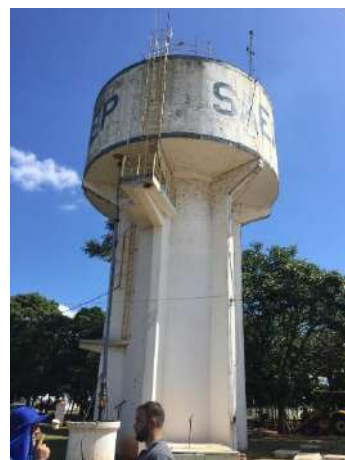
Figura 115 - R2 das ETAs II e III Fonte: Amplar Engenharia
