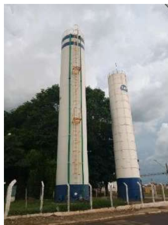
Figura 139 - Reservatório da esquerda: reservatório Jd. Alto das árvores; Reservatório da direita: reservatório de água salobra de poço usado p/ lavagem das ruas Fonte: Amplar Engenharia
