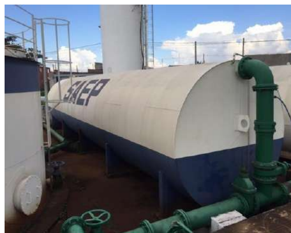
Figura 141 - Reservatório apoiado ETA Sta. Fé Fonte: Amplar Engenharia
