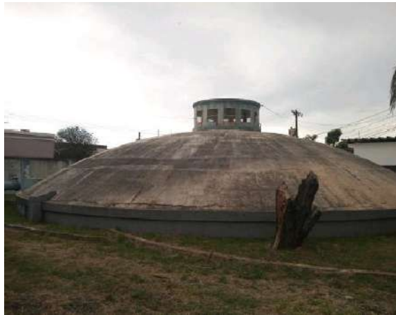
Figura 124 – Reservatório 2 Pátio da SAEP Fonte: Amplar Engenharia
