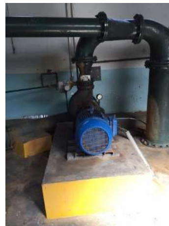
Figura 24 - Bomba Captação 1 Ribeirão Descaroçador Fonte: Amplar Engenharia
