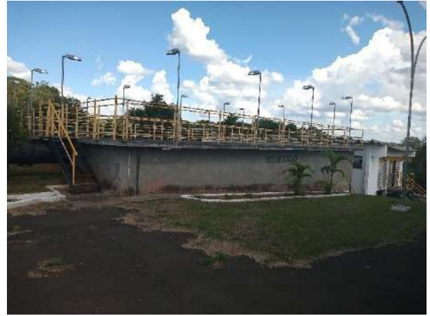
Figura 35 - Poço de sucção Fonte: Amplar Engenharia
