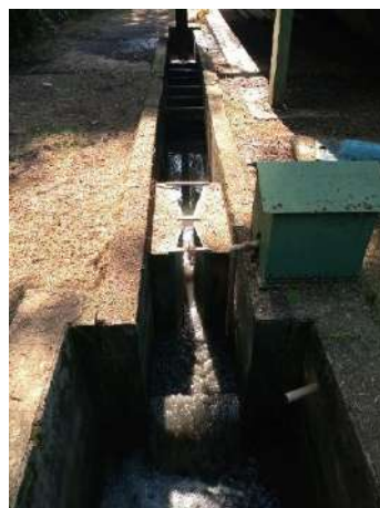
Figura 215 - Medidor de vazão de saída da ETE Santa Fé Fonte: Amplar Engenharia
