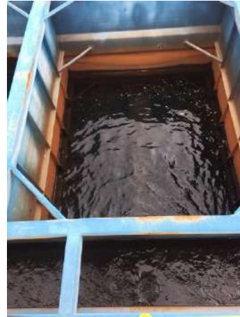
Figura 101 - Filtro 2 Fonte: Amplar Engenharia
