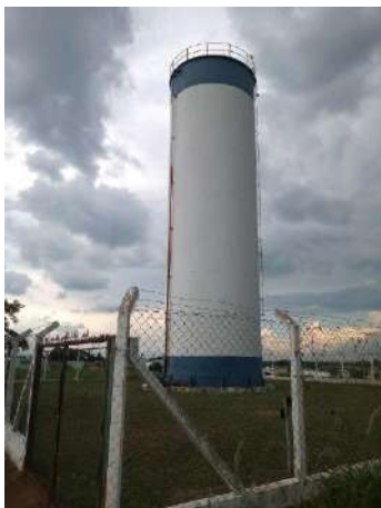
Figura 134 - Reservatório San Martinho Fonte: Amplar Engenharia
