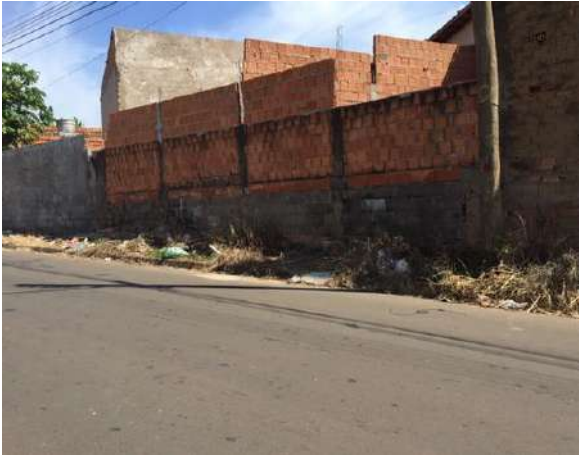
Figura 237 - Descarte irregular de resíduo Fonte: Amplar Engenharia
