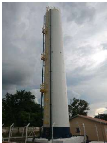
Figura 138 - Reservatório Jd. Marília Fonte: Amplar Engenharia
