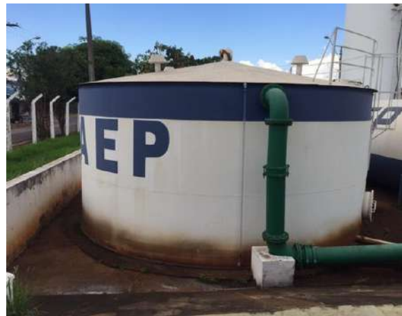
Figura 143 - Reservatório apoiado ETA Sta. Fé Fonte: Amplar Engenharia
