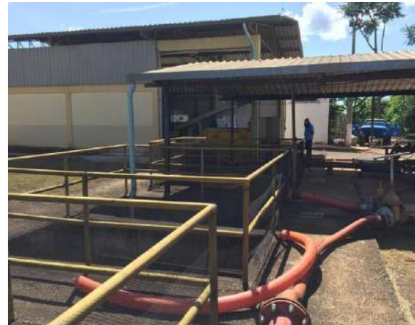
Figura 92 - Sistema de Tratamento de Lodo Fonte: Amplar Engenharia
