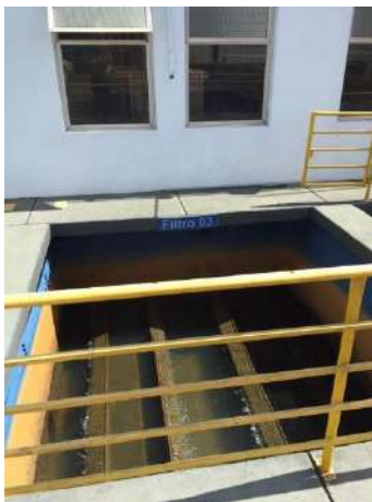
Figura 71 - Filtro 3 ETA II Fonte: Amplar Engenharia
