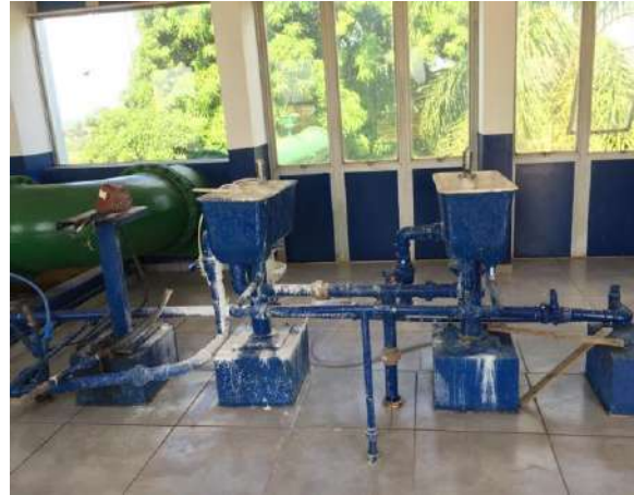
Figura 76 - Adição de produtos químicos ETA II Fonte: Amplar Engenharia
