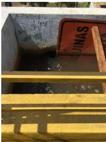
Figura 73 - Entrada de água para a ampliação ETA II Fonte: Amplar Engenharia
