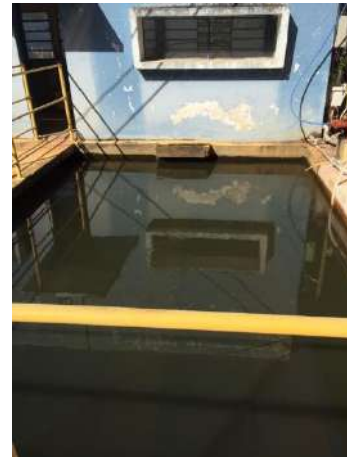
Figura 51 - Filtro 1 ETA I Fonte: Amplar Engenharia
