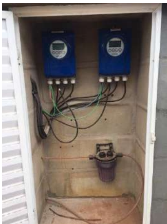
Figura 102 - Medidor de vazão de entrada Fonte: Amplar Engenharia
