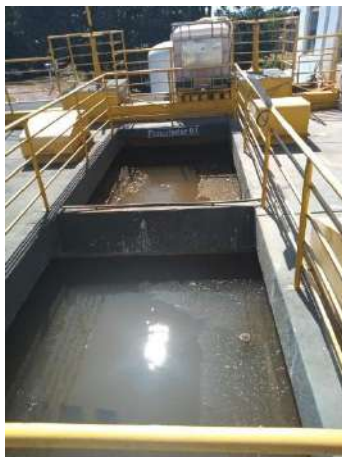
Figura 67 - Flocculador 2 ETA II Fonte: Amplar Engenharia
