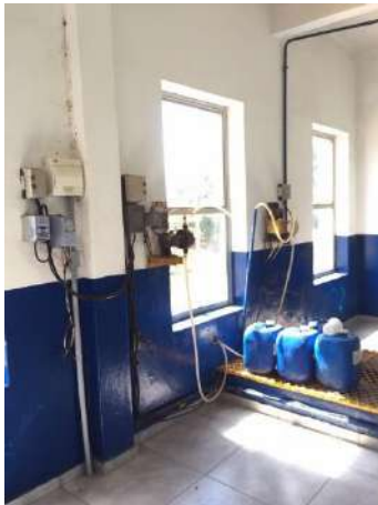
Figura 77 - Adição de produtos químicos ETA II Fonte: Amplar Engenharia
