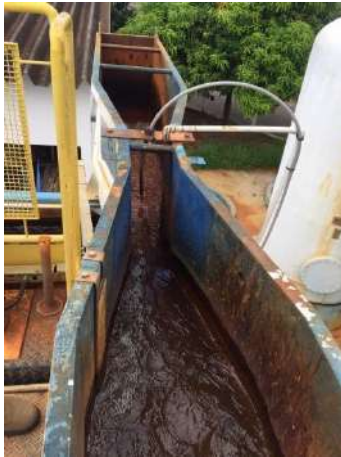
Figura 96 - Calha Parshall com adição de produtos Fonte: Amplar Engenharia
