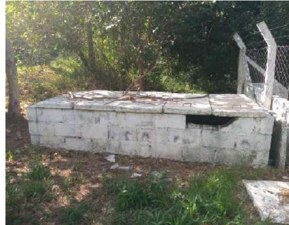
Figura 164 - EEEB Verona Fonte: Amplar Engenharia
