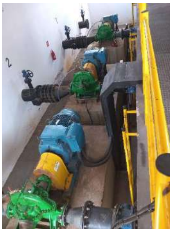
Figura 32 - Conjuntos motobombas Fonte: Amplar Engenharia
