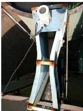
Figura 212 - Medidor de vazão de entrada ETE Santa Fé Fonte: Amplar Engenharia
