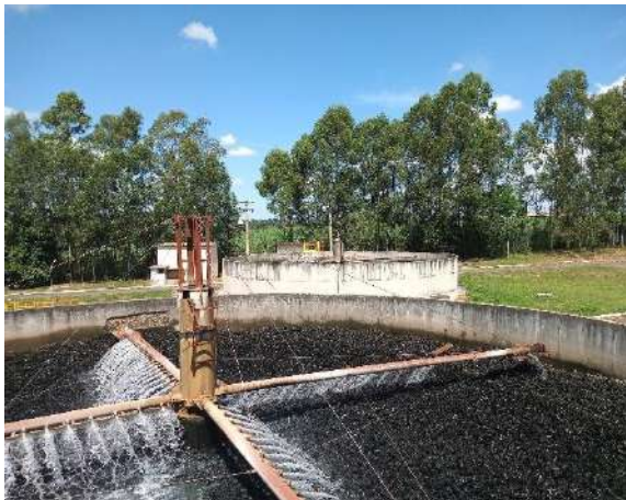
Figura 200 - Reator Biológico ETE Laranja Azeda Fonte: Amplar Engenharia
