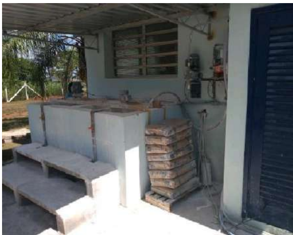
Figura 85 - Adição de produtos químicos ETA III Fonte: Amplar Engenharia
