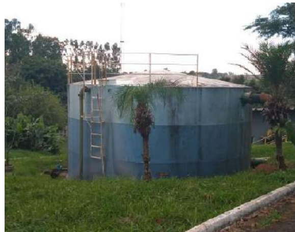
Figura 113 - Reservatório metálico apoiado ETA I Fonte: Amplar Engenharia
