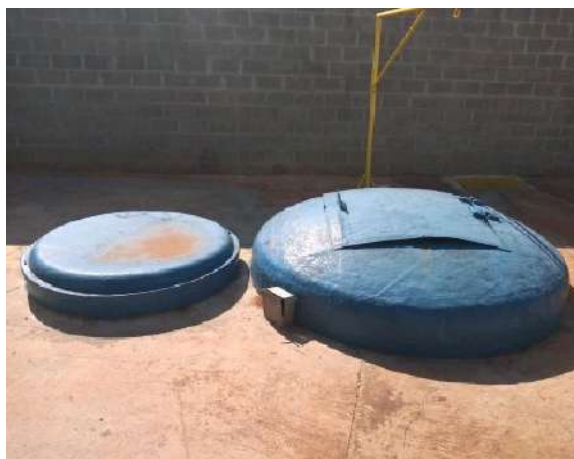
Figura 173 - EEEB Amente Fonte: Amplar Engenharia
