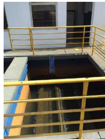
Figura 72 - Filtro 4 ETA II Fonte: Amplar Engenharia
