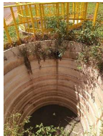
Figura 195 - Caixa de contenção de gordura ETE Laranja Azeda Fonte: Amplar Engenharia
