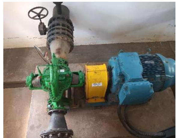
Figura 33 - Conjunto motobombas Fonte: Amplar Engenharia
