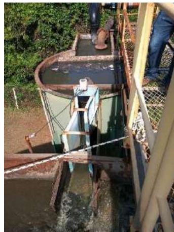
Figura 211 - Calha Parshall ETE Santa Fé Fonte: Amplar Engenharia
