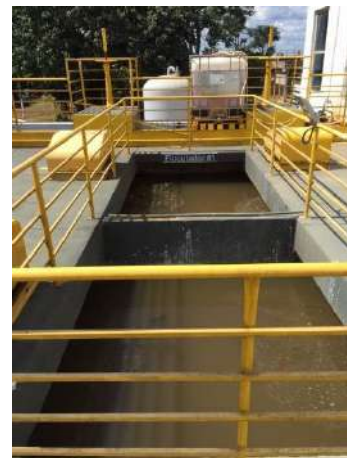
Figura 66 - Flocculador 1 ETA II Fonte: Amplar Engenharia
