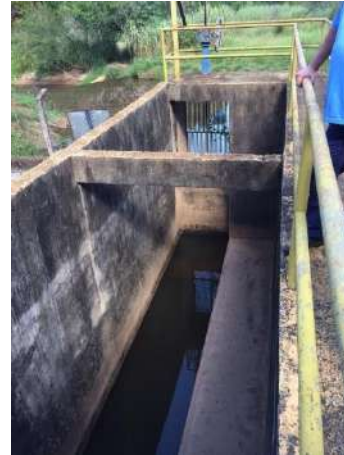
Figura 22 - Captação Ribeirão Descaroçador Fonte: Amplar Engenharia
