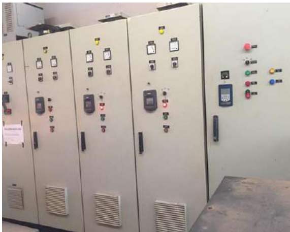
Figura 161 - Painel de controle das bombas da EEEB ETE Laranja Azeda Fonte: Amplar Engenharia
