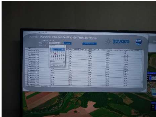
Figura 152 - Painel de controle dos reservatórios Fonte: Amplar Engenharia
