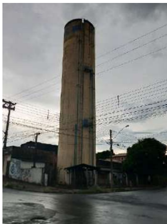
Figura 128 - Reservatório Jd. São Valentim Fonte: Amplar Engenharia
