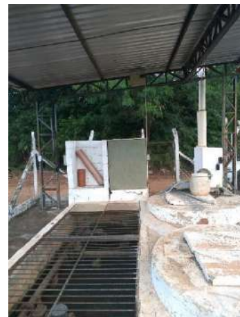
Figura 168 - EEEB Millenium Fonte: Amplar Engenharia
