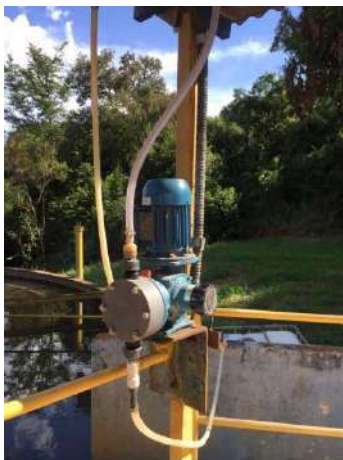
Figura 56 - Bomba dosadora Fonte: Amplar Engenharia
