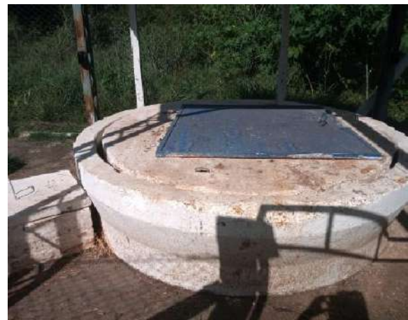
Figura 166 - EEEB Verona Fonte: Amplar Engenharia
