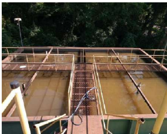
Figura 214 - Decantadores da ETE Santa Fé Fonte: Amplar Engenharia
