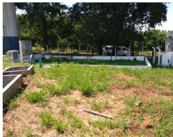
Figura 147 - Reservatório enterrado Ch. de Emas Fonte: Amplar Engenharia
