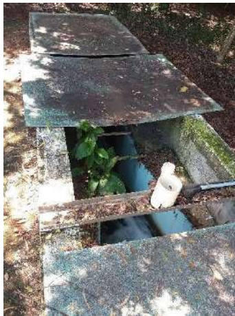
Figura 204 - Medidor de saída ETE Laranja Azeda Fonte: Amplar Engenharia
