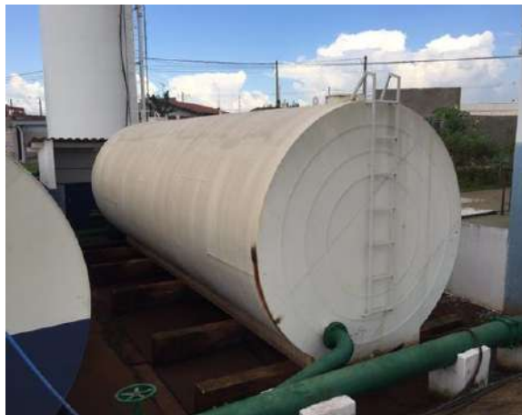
Figura 142 - Reservatório apoiado ETA Sta. Fé Fonte: Amplar Engenharia
