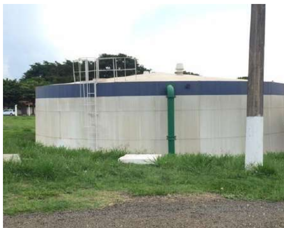
Figura 144 - Reservatório apoiado ETA Sta. Fé Fonte: Amplar Engenharia
