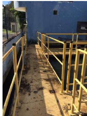
Figura 60 - Reformas necessárias: pintura e rachaduras Fonte: Amplar Engenharia
