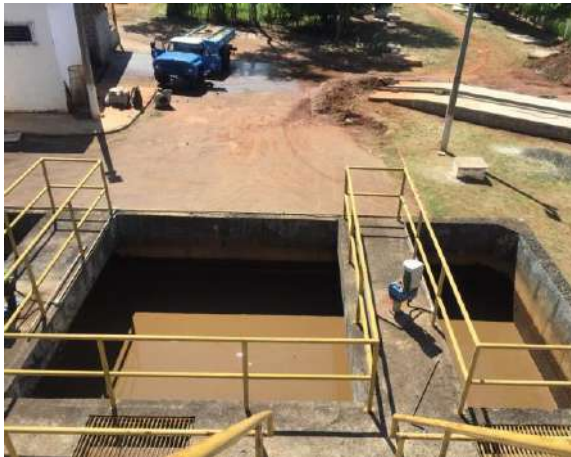
Figura 91 - Sistema de Tratamento de Lodo Fonte: Amplar Engenharia
