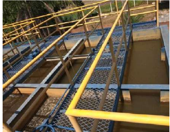
Figura 82 - Floculador ETA III Fonte: Amplar Engenharia
