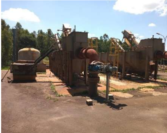
Figura 190 - Estação de Pré Tratamento Completa ETE Laranja Azeda Fonte: Amplar Engenharia
