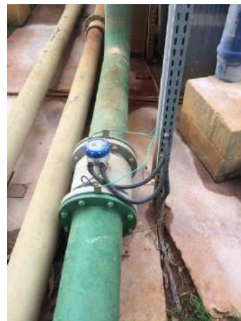
Figura 103 - Medidor de vazão de entrada Fonte: Amplar Engenharia
