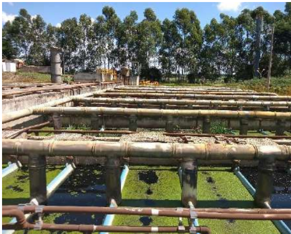
Figura 198 - Reator UASB ETE Laranja Azeda Fonte: Amplar Engenharia
