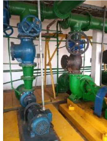
Figura 90 - Sistema de retro-lavagem dos filtros Fonte: Amplar Engenharia
