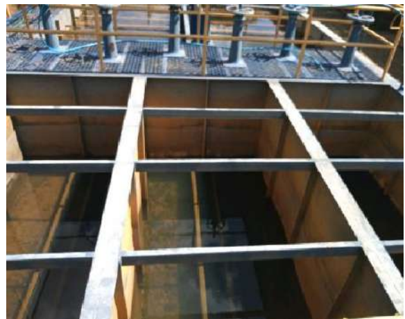
Figura 84 - Filtros ETA III Fonte: Amplar Engenharia
