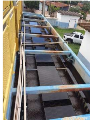
Figura 97 - Decantador 1 Fonte: Amplar Engenharia
