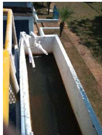
Figura 86 - Adição de produtos químicos ETA III Fonte: Amplar Engenharia
