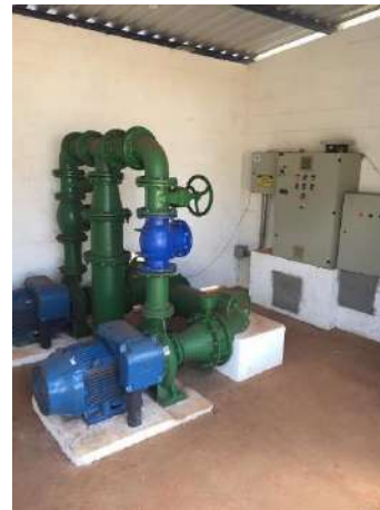
Figura 154 - Estação Pressurizadora de Água Tratada Fonte: Amplar Engenharia
