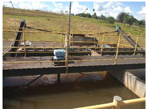
Figura 37 - Caixa de areia Fonte: Amplar Engenharia
