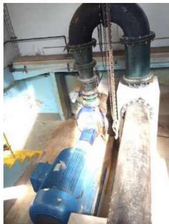
Figura 25 - Bomba Captação 2 Ribeirão Descaroçador Fonte: Amplar Engenharia
