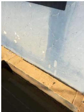
Figura 61 - Reformas necessárias: pintura e rachaduras Fonte: Amplar Engenharia
