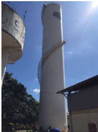
Figura 122 - R9 das ETAs II e III Fonte: Amplar Engenharia
