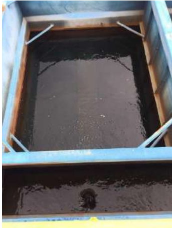
Figura 100 - Filtro 1 Fonte: Amplar Engenharia
