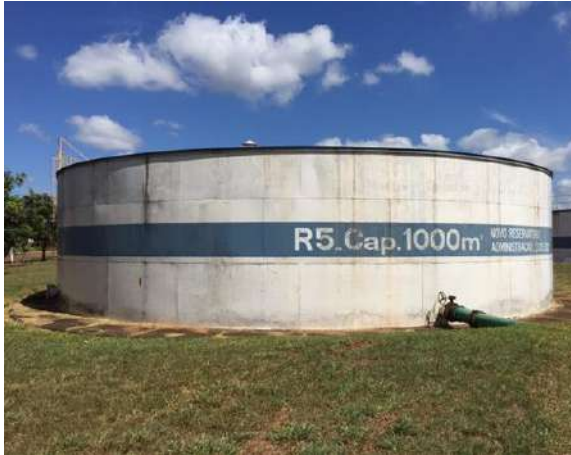
Figura 118 - R5 das ETAs II e III Fonte: Amplar Engenharia
