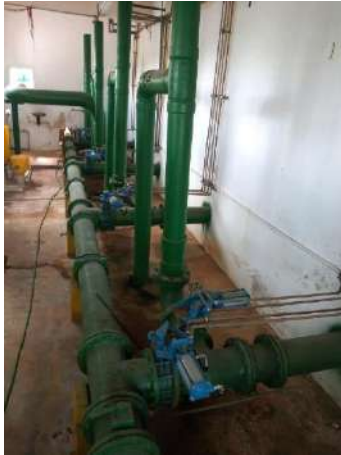
Figura 89 - Sistema de retro-lavagem dos filtros Fonte: Amplar Engenharia
