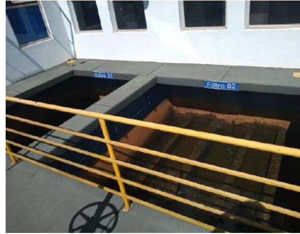
Figura 70 - Filtros 1 e 2 da ETA II Fonte: Amplar Engenharia
