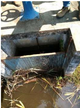
Figura 45 - Gradeamento na captação Fonte: Amplar Engenharia
