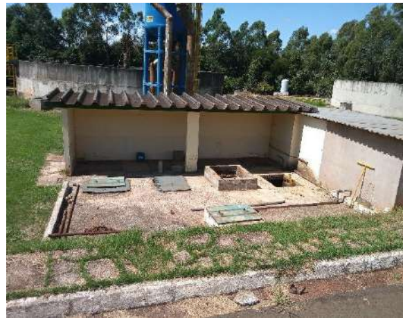
Figura 199 - Estação elevatória para os reatores biológicos ETE Laranja Azeda Fonte: Amplar Engenharia
