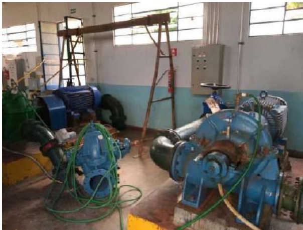
Figura 153 - Estação Elevatória de Água Tratada Fonte: Amplar Engenharia
