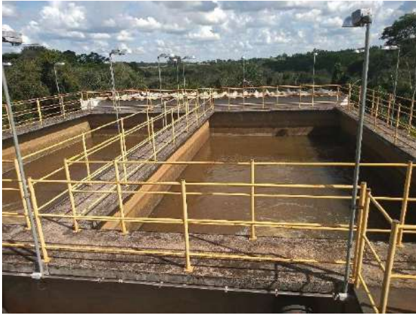
Figura 34 - Poço de sucção Fonte: Amplar Engenharia
