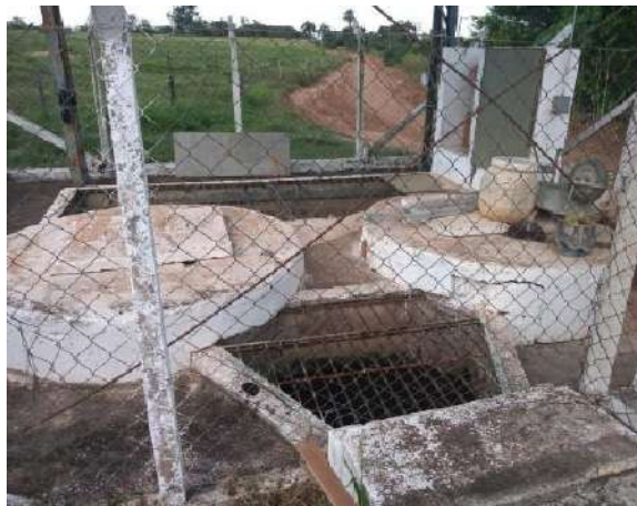
Figura 169 - EEEB Millenium Fonte: Amplar Engenharia
