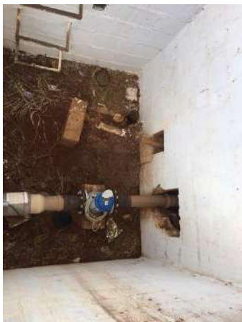
Figura 104 - Medidor de vazão de saída Fonte: Amplar Engenharia
