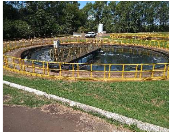
Figura 201 - Decantador ETE Laranja Azeda Fonte: Amplar Engenharia
