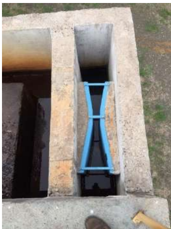
Figura 110 - Sistema de Tratamento de Lodo Fonte: Amplar Engenharia
