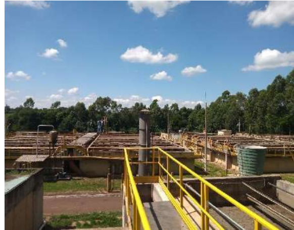
Figura 197 - Estruturas do Reator da ETE Laranja Azeda Fonte: Amplar Engenharia
