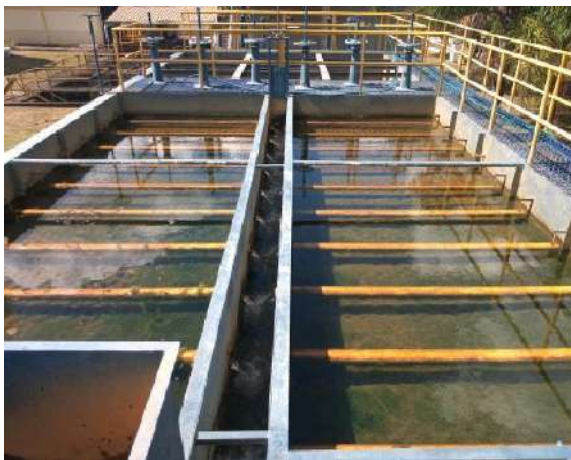
Figura 83 - Decantador ETA III Fonte: Amplar Engenharia
