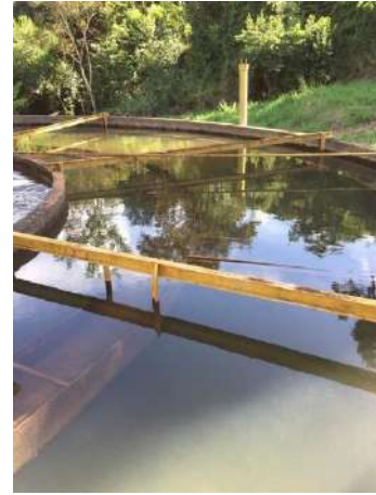
Figura 49 - Decantador ETA I Fonte: Amplar Engenharia
