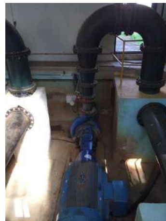
Figura 26 - Bomba Captação 2 Ribeirão Descaroçador Fonte: Amplar Engenharia
