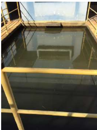
Figura 52 - Filtro 2 ETA I Fonte: Amplar Engenharia
