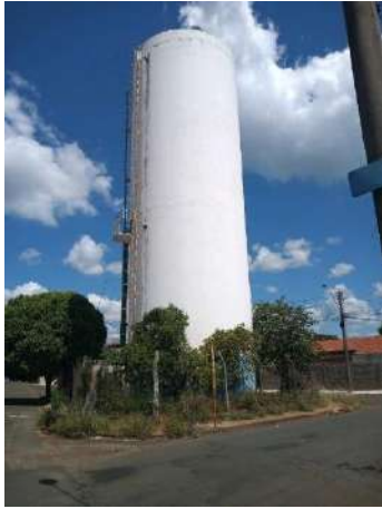
Figura 130 - Reservatório Vila Belmiro Fonte: Amplar Engenharia
