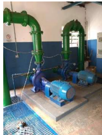
Figura 46 - Conjunto motobombas Fonte: Amplar Engenharia
