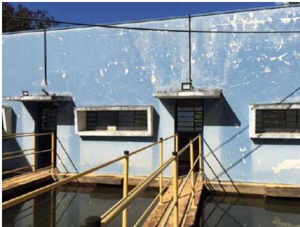
Figura 59 – Reformas necessárias: pintura e rachaduras Fonte: Amplar Engenharia
