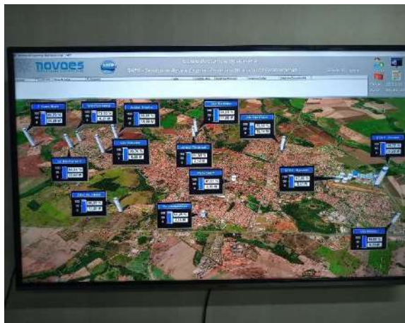
Figura 148 - Painel de controle dos reservatórios Fonte: Amplar Engenharia
