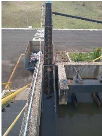
Figura 38 - Caixa de areia Fonte: Amplar Engenharia
