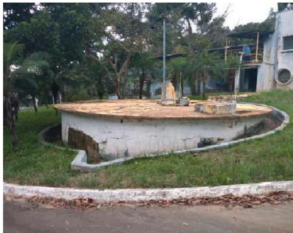
Figura 112 - Reservatório semi enterrado ETA I Fonte: Amplar Engenharia
