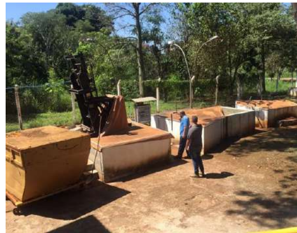
Figura 162 - Gradeamento da EEEB ETE Laranja Azeda Fonte: Amplar Engenharia
